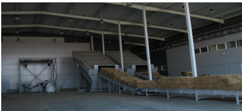
Система подачі тюків соломи в котельню для спалювання соломи
