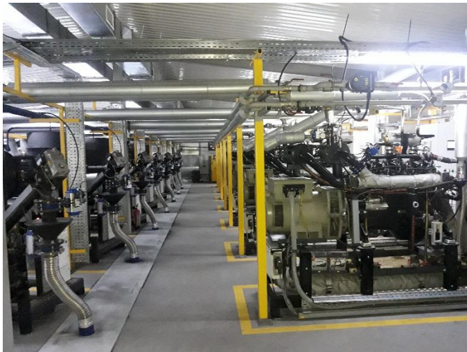
ТЕЦ на біомасі за технологію термохімічної газифікації в м.Чернігів (0,5 МВт ел + 0,8 МВт т )
