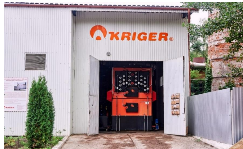
Котельня для спалювання деревної тріски потужністю 2,5 МВт у психіатричній лікарні № 1, с. Зарічани Житомирської обл.
